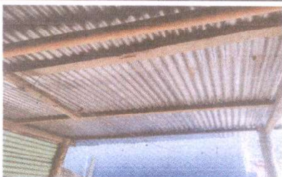
Foto 1: Lámina deteriorada. 40 M2 y estructura de madera por metal por mal estado en cocina.
