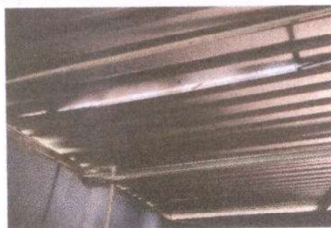
Foto 1: Cambio de laminas troquelada aluzinc calibre 26 total 15 metros. Y estructura de techo a razon que esta muy distante los durmientes o constaneras y eso permite que se unda el lienso de lamina
