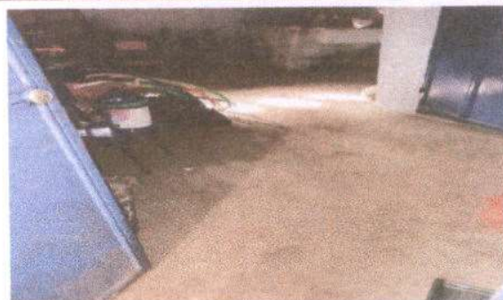
Foto 2. Se colocará piso cerámico ya que se tiene el conveniente de que es torta de cemento y es difícl su aseo. Con total de 22 metros.
