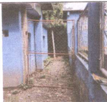
Foto 3: Portón para acceso a la cocina y baño ya que el existente esta fabricado de materiales inseguros. (1.50 x 2.20 m)
